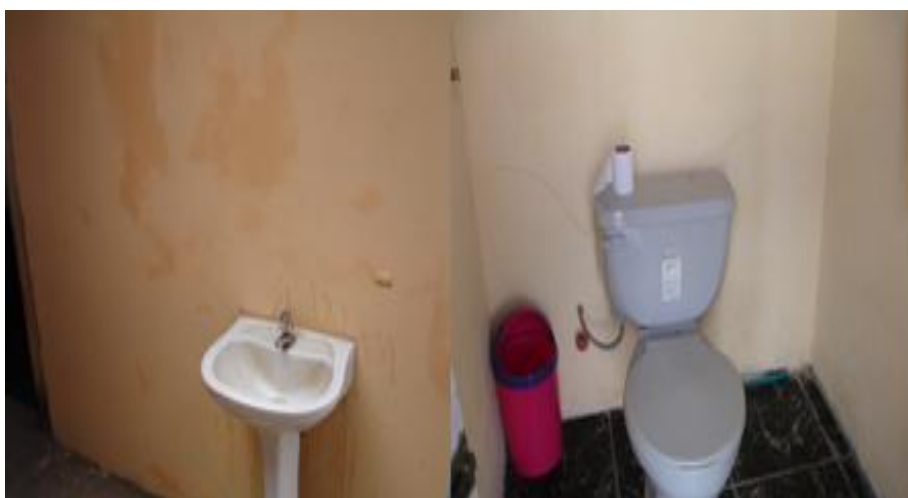
Apéndice 57. Mejores condiciones higiénicas de lavamanos y baterías sanitarias de la institución de la escuela René Zea después de la minga escolar
