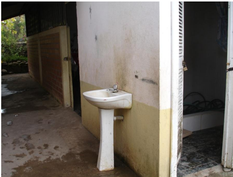
Apéndice 16. Condiciones en las que se encuentra las paredes de la escuela René Zea antes de la minga escolar Fuente: Institución educativa René Zea.
