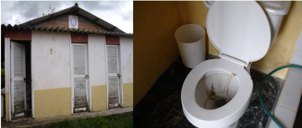
Apéndice 18. Malas condiciones higiénico sanitario en las que se encuentra los baños y puertas de la escuela René Zea antes de la minga escolar Fuente: Institución educativa René Zea.
