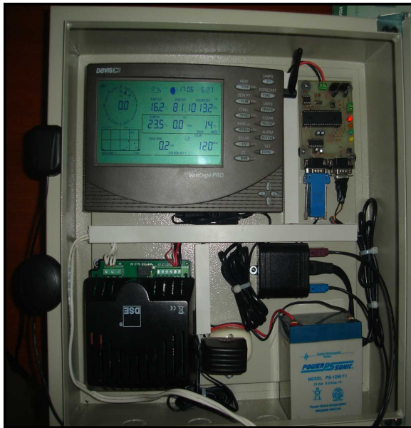
Figura 4.2b Instalación final de los componentes del panel de control
