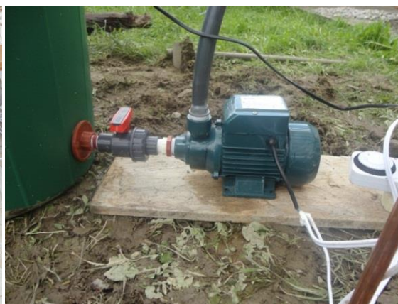
Figura 25: Sistema de recirculación del agua. Fuente: Autor.
