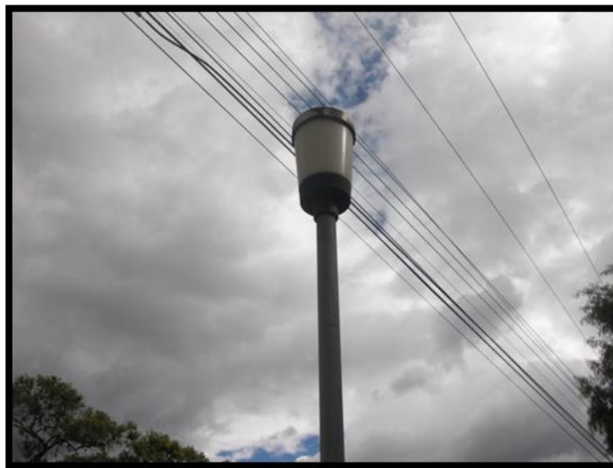
Figura N°6. Luminaria de la entrada sur del sendero. El autor.
