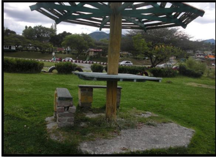
Figura N°20. Chozón y bancas en mal estado del Kartódromo. El autor.
