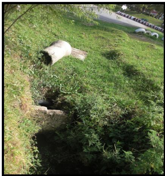
Figura N°22. Alcantarillado del Kartódromo.
