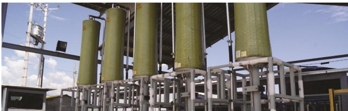
Figura No. 19: Planta de tratamiento de lixiviados.
