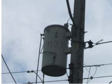
Identificación y toma de datos del transformador
