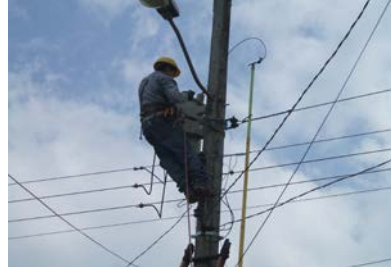
Transformador desenergizado por seguridad
