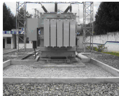
Cubetos para aceite en caso de derrames de aceite de los transformadores Instalados por la EERSSA en los transformadores de las subestaciones
