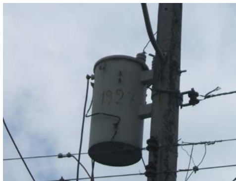
Foto 1. Transformador de distribución.
