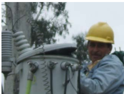
Foto 3. Transformador sin válvula, extracción de aceite a través de la tapa superior.
