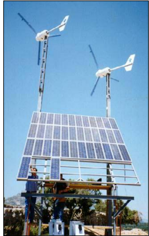
Fig. 21. Instalación mixta eólica fotovoltaica. [Tomado de: http://www.solener.com/intro.html ]
