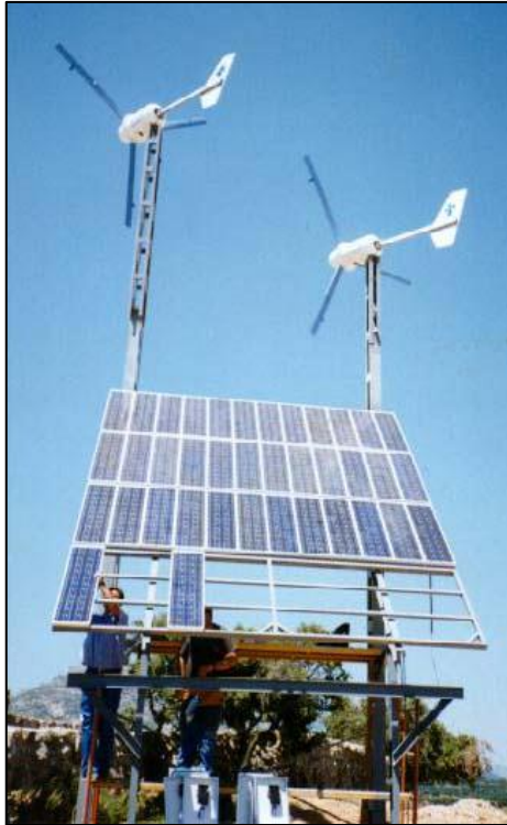
Figura.3.4. Instalación mixta eólica fotovoltaica. Fuente: http://www.solener.com/intro.html ]
