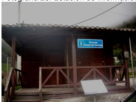
Fotografía 26. Estación de información de la EPQ fuera de operación. Nono
