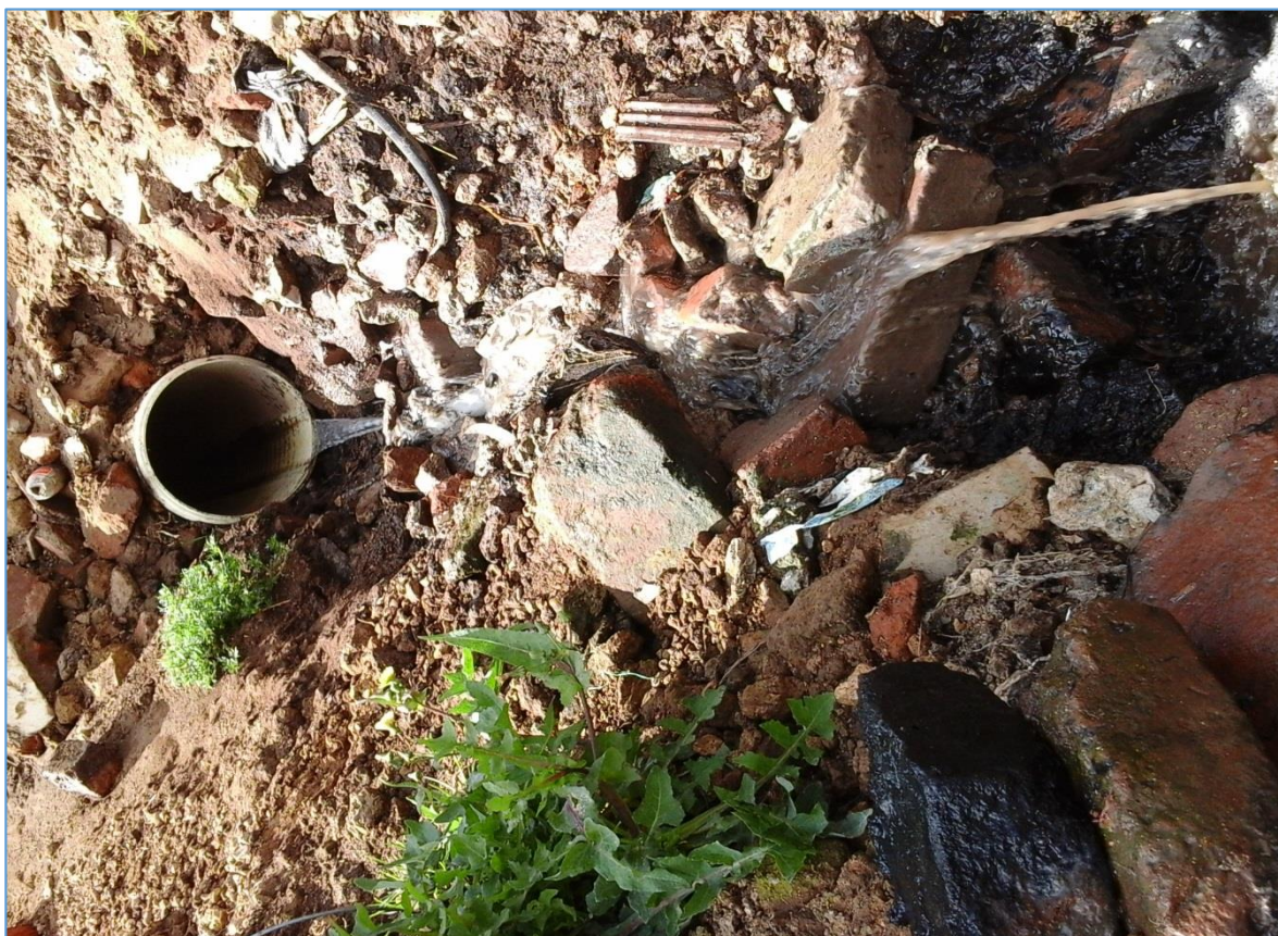
Foto 4. Descarga de aguas residuales, barrio 5 de junio
