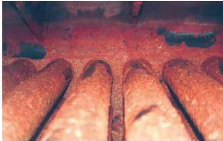
Figura 3. Interior de caldera con incrustaciones. Fuente: (Comunidad de Madrid, 2013).
