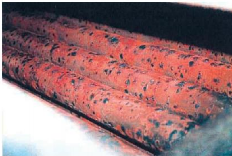
Figura 4. Tubería de caldera con corrosión. Fuente: (Comunidad de Madrid, 2013).
