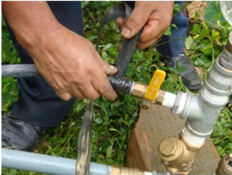
FOTO 2. Instalación en campo
