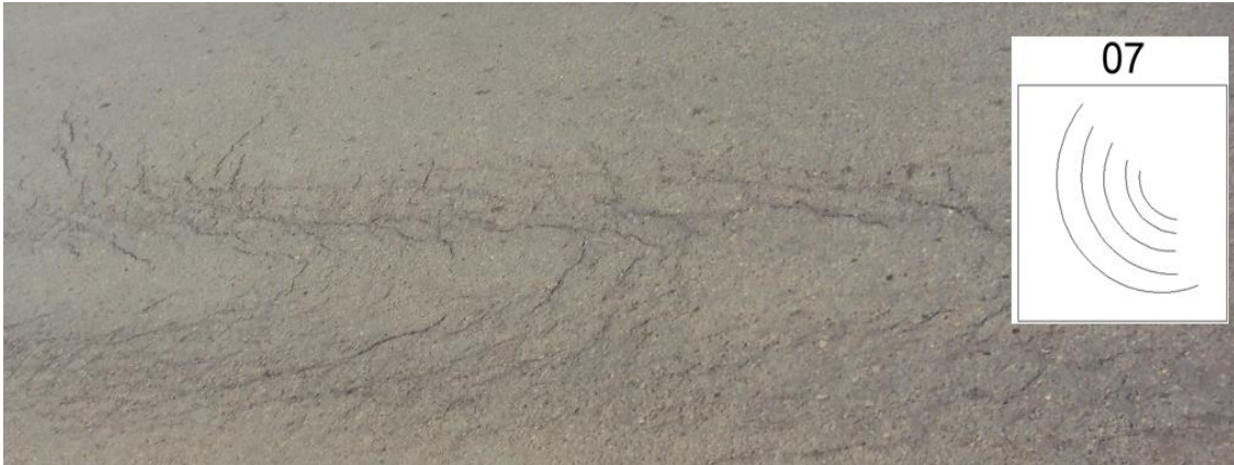
Figura 18. Grietas parabólicas U.M. 331 (VIZIR).
