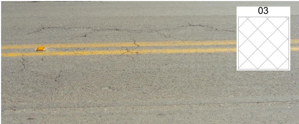
Figura 2. Grietas en bloque U.M. 331 (PCI).
