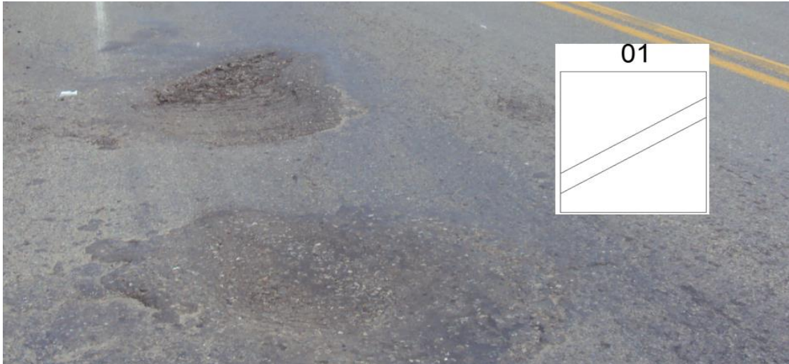
Figura 16. Ahuellamiento y otras deformaciones estructurales U.M. 331 (VIZIR).
