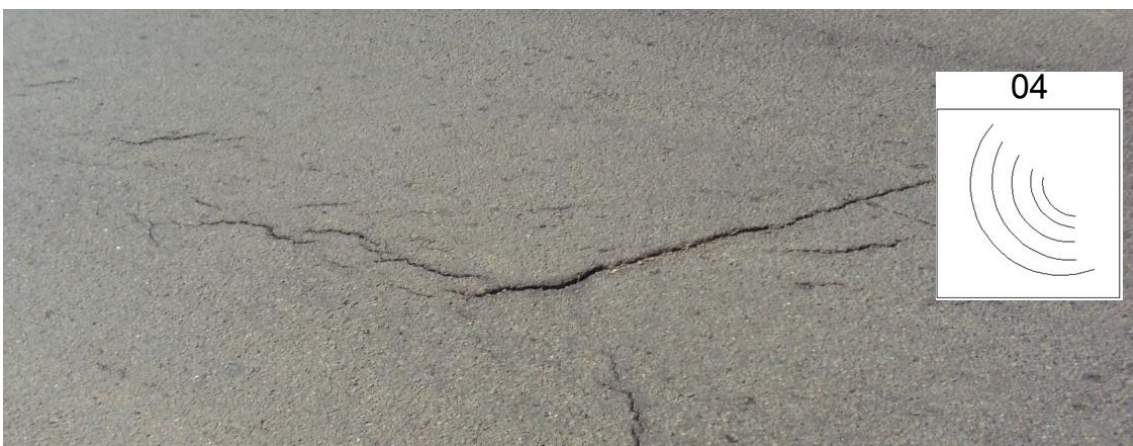
Figura 3. Grietas de arco U.M. 331 (PCI).
