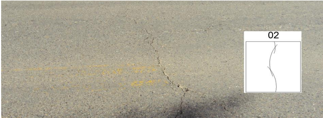
Figura 1. Grietas longitudinales U.M. 331 (PCI).
