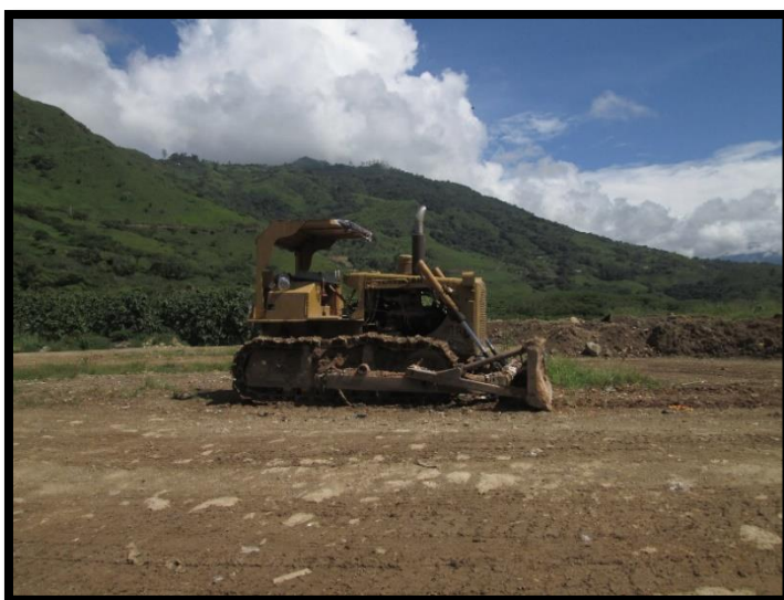
Figura 5.5: Compactadora de residuos.
