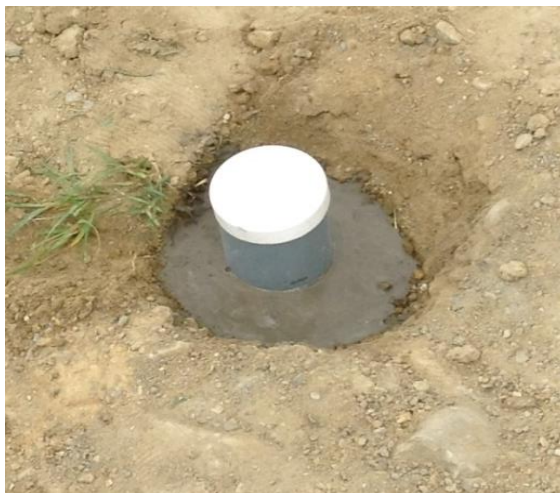
Figura 27. Tubos de acceso. Fuente: Elaboración Propia.
