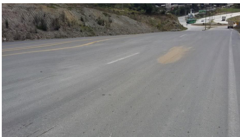
Figura 73. Movimientos de masa por procesos de variación de humedad. Fuente: Elaboración Propia.
