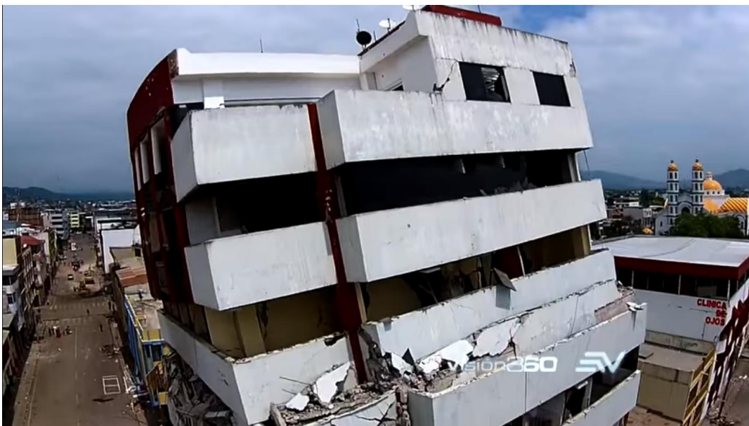
Ilustración 2. Destrucción. Edificio. Terremoto
