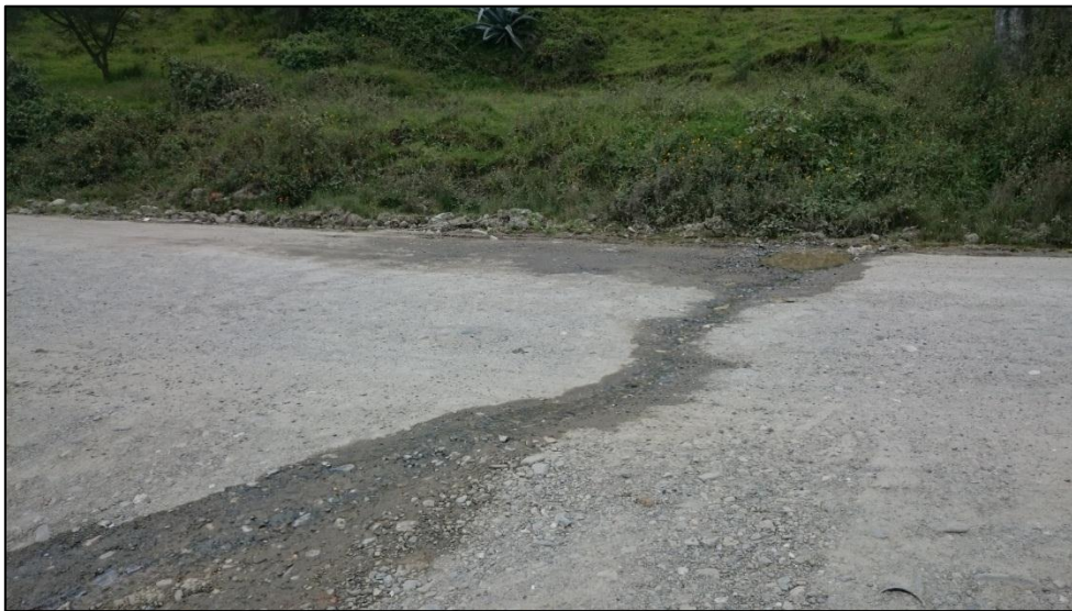
Figura 29. Escurrimientos de agua por acumulación de lluvias.
