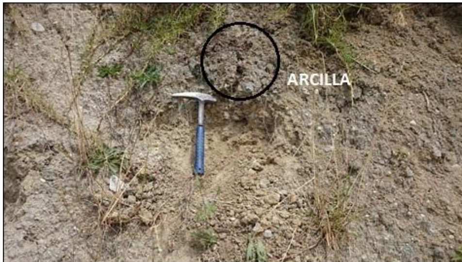
Figura 25. Zona superior del movimiento de ladera, formado por areniscas y arcilla.
