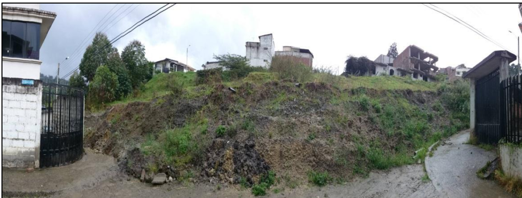
Figura 8. Deslizamiento al pie de las viviendas.
