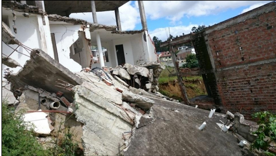
Figura 7. Daños en las edificaciones, producto del deslizamiento.
