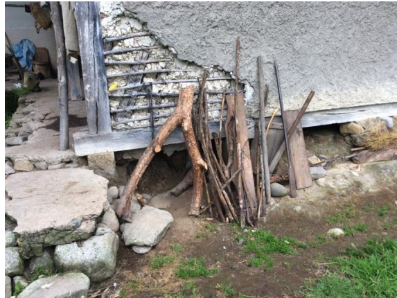
Imagen 30: Desprendimiento del revoque Fuente: (Vacacela, 2016)
