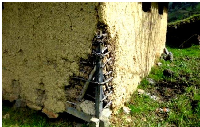
Imagen 27: Desprendimiento de material de recubrimiento y de relleno, por acción del agua. Fuente: (Vacacela, 2016)
