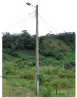
Figura 4.23 Infraestructura_Iluminación Fuente. El autor
