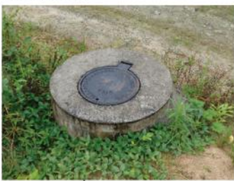
Figura 4.18 Infraestructura_Alcantarillado Fuente. El autor
