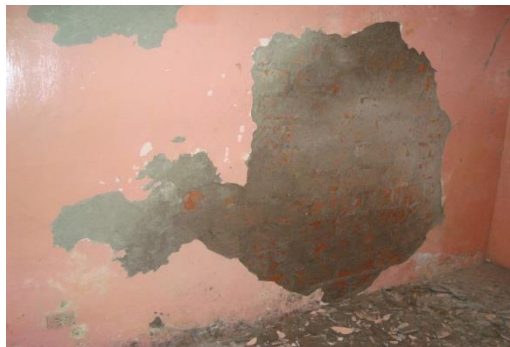
Daño por humedad
