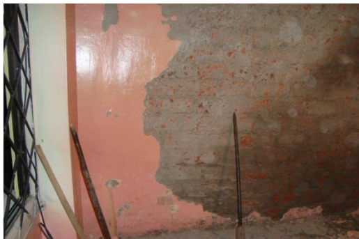
Parte afectada y parte sana
