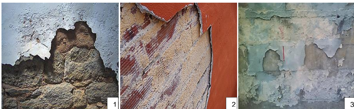
Figura 11: Lesión mecánica, desprendimiento 1 – 3. Presencia de desprendimiento
