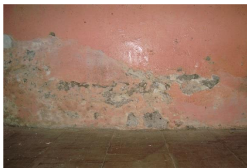
Humedad y presencia de moho
