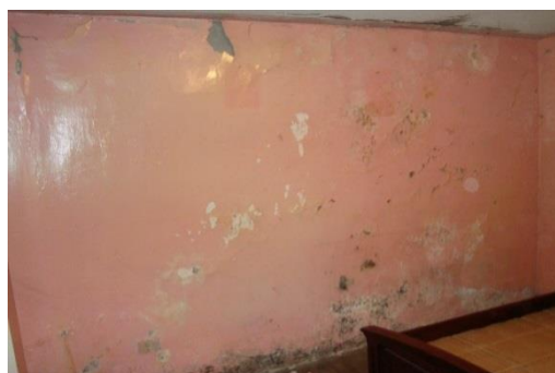
Patología constructiva humedad
