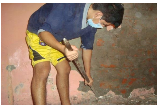
Picar y extraer la parte afectada
