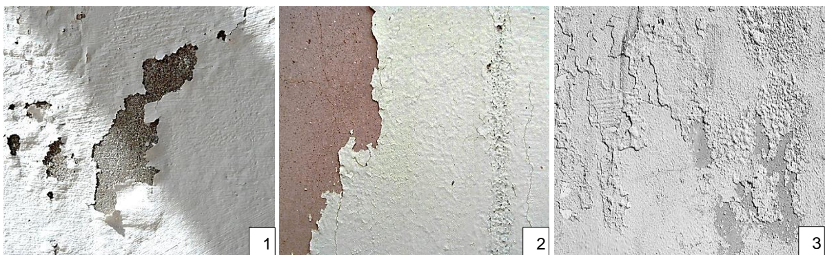
Figura 6: Lesión física, humedad 1 – 3. Presencia de humedad
