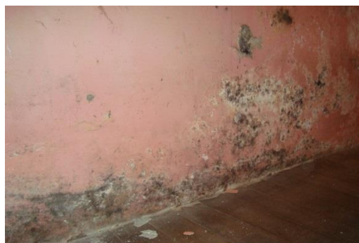
Humedad en la base de la pared
