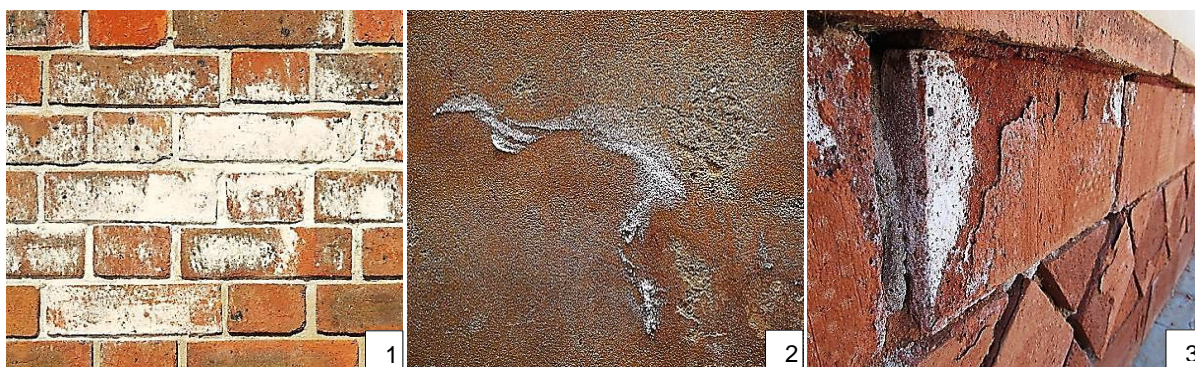
Figura 12: Lesión química, eflorescencias 1 – 3. Presencia de eflorescencias en mampostería
