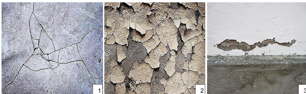
Figura 8: Lesión física, erosión 1 – 3. Presencia de erosión
