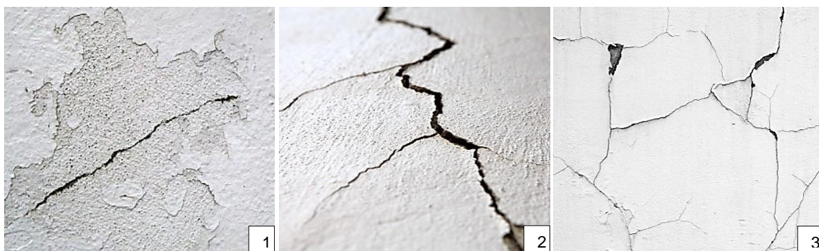
Figura 10: Lesión mecánicas, fisuras 1 – 3. Presencia de fisuras
