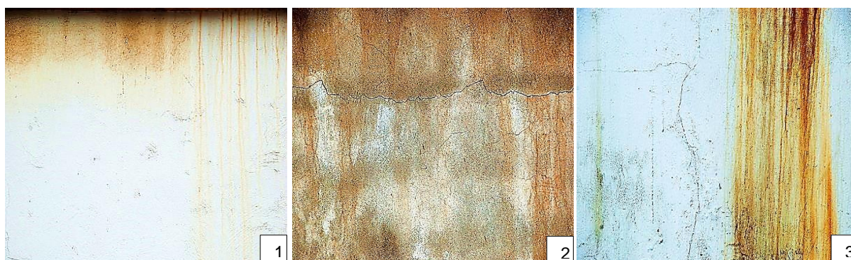
Figura 13: Lesión química, oxidaciones 1 – 3. Presencia de oxidaciones y corrosiones
