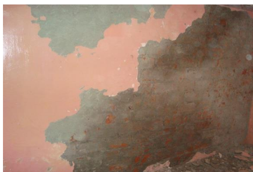
La mampostería afectada en gran parte
