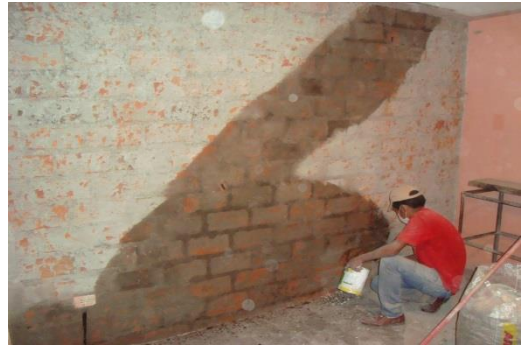
Impermeabilizante zona afectada
