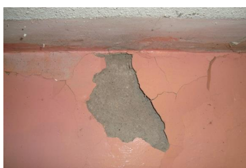
Desprendimiento del mortero
