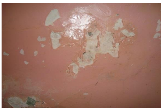
Desprendimiento de la pintura
