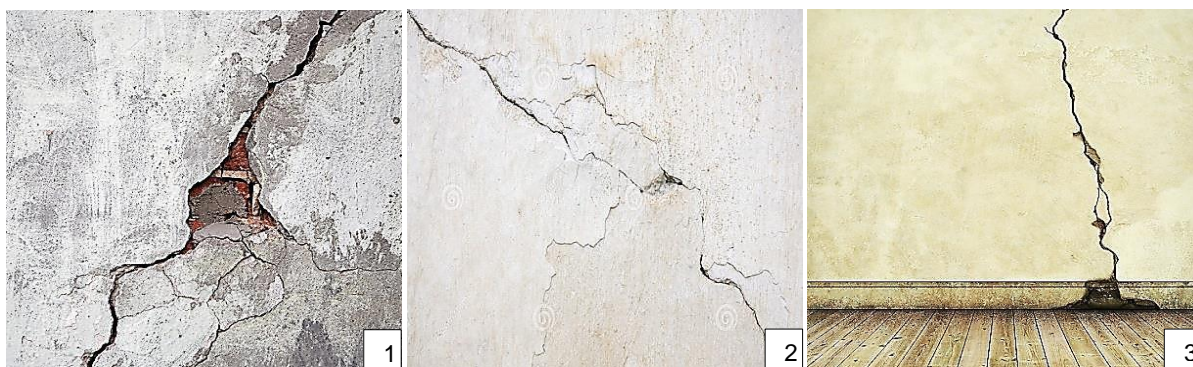
Figura 9: Lesión mecánica, grietas 1 – 3. Presencia de grietas
