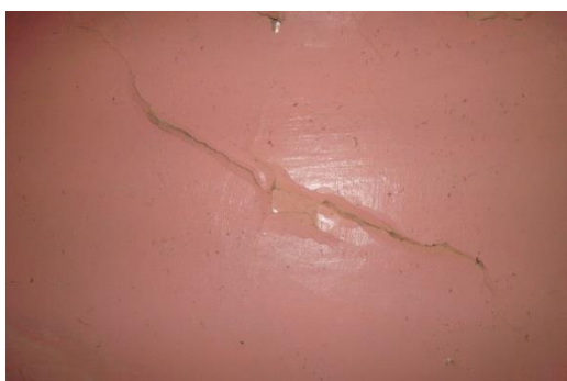
Cortes, fisuras y grietas
