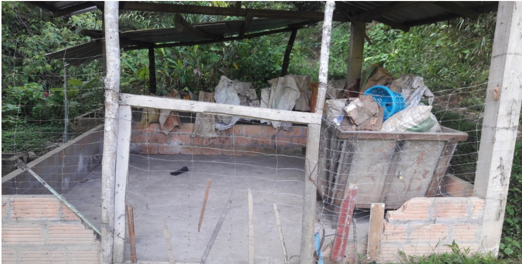
Figura 4.- Caseta en mal estado donde se almacena provisionalmente los residuos
