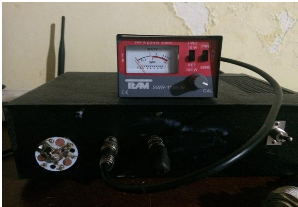
Figura 58. Medición del ROE entre el transmisor y la antena transmisora. Fuente: Autores Elaboración: Autores
