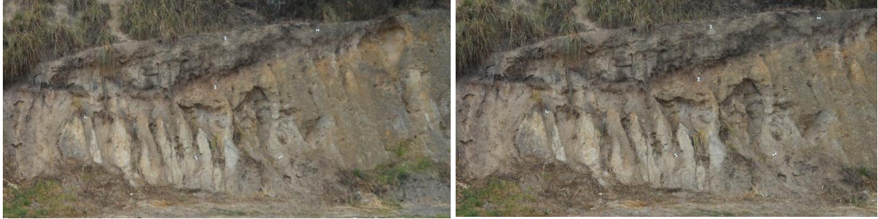
Figure 34: "Talud N.2" estado inicial (9-nov-2016) y estado final (20-dic-2016)
