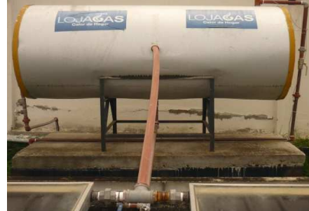
Tanque de Almacenamiento
