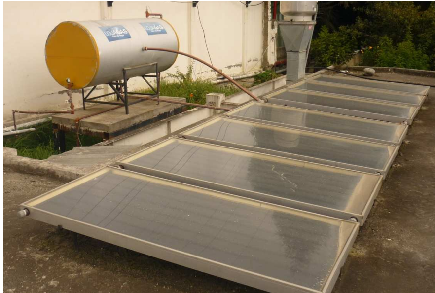
Implementación de los colectores solares
