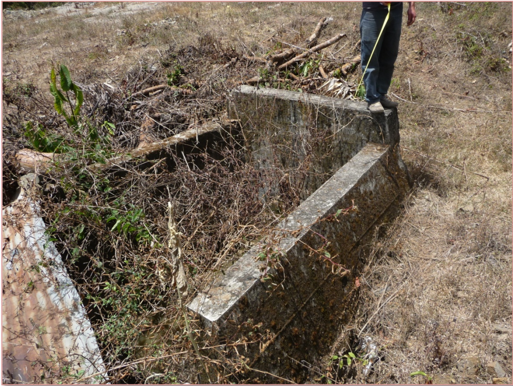
Imagen 4.2 Descarga existente en Nueva Fátima.
