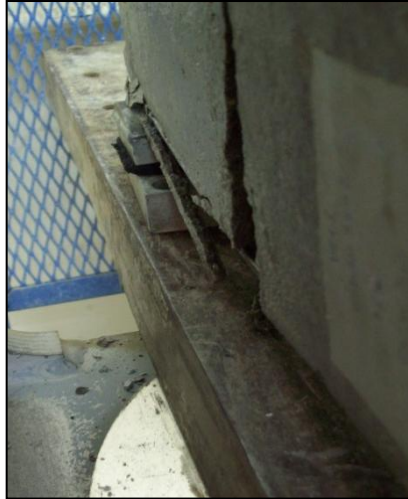
Figura 4.3.1_1. Viga sin recubrimiento Fuente: El Autor
