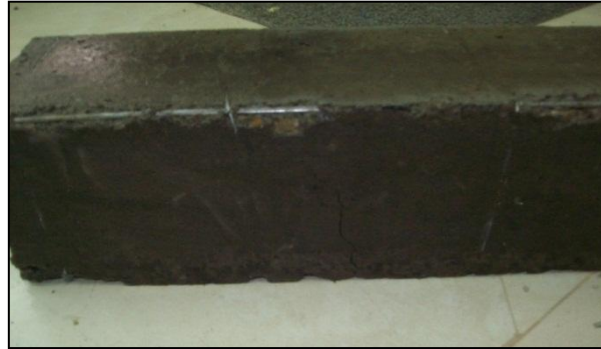
Figura 4.3.1_5. Desprendimiento del hormigón en las aristas de los elementos Fuente: El Autor.
