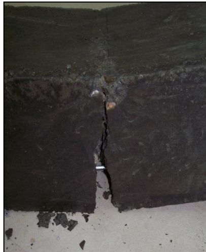
Figura 4.3.1_3. Viga con 2.5 centímetros de recubrimiento Fuente: El Autor.
