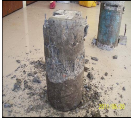
Figura 4.3.2_3. Desprendimiento inmediato del hormigón en elementos con recubrimiento insuficiente o nulo. Fuente: El Autor.
