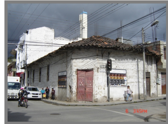
Foto 3.20 Deterioro físico de bien inmueble Fuente: La autora Ubicación: Calle Olmedo y Rocafuerte (esq. Sur este)
