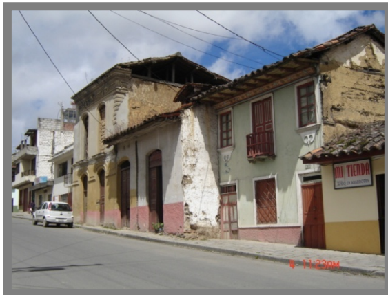
Foto 3.19 Deterioro físico de materiales de edificación Fuente: La autora Ubicación: Calle Bolívar entre Cariamanga y Céllica
