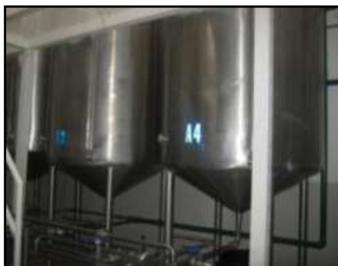
Fotografía 7: Tanques de Acidificación
