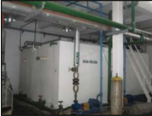
Fotografía 16: Tinas de Agua Helada
