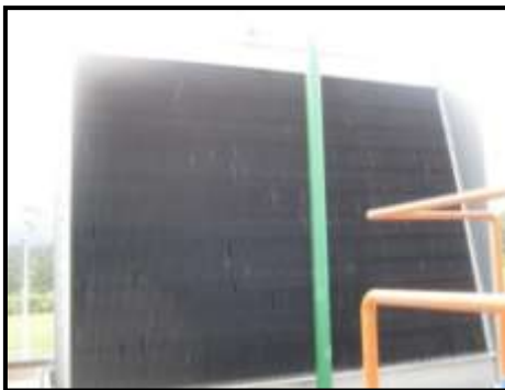
Fotografía 17: Torre de Enfriamiento
