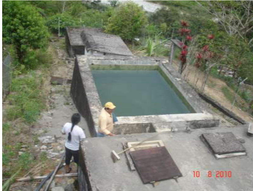
Filtro Lento sin arena para filtros en PT. La Paz.
