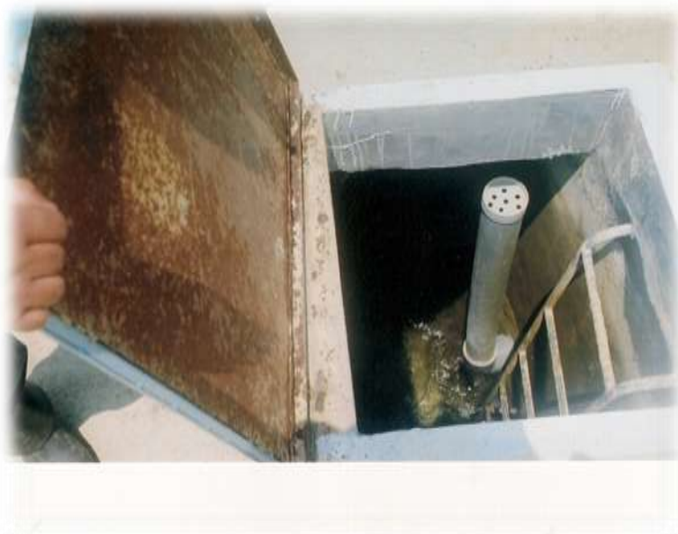
Tanque de reserva vacío; no vale la tubería de entrada a este tanque.
