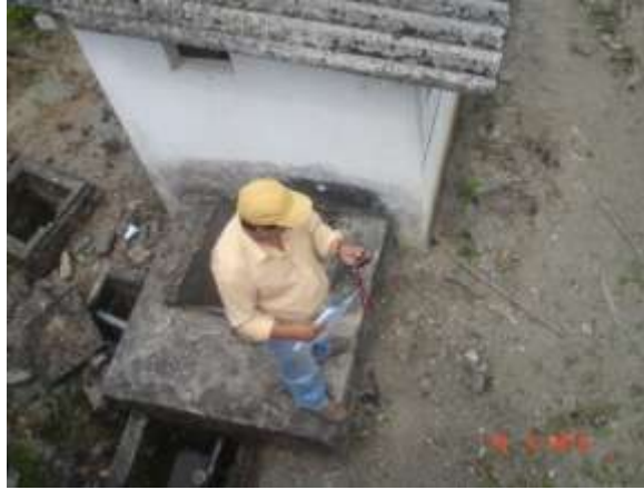
Caja de revisión sin tapa de cemento, ni metálica en la Planta de Tratamiento
