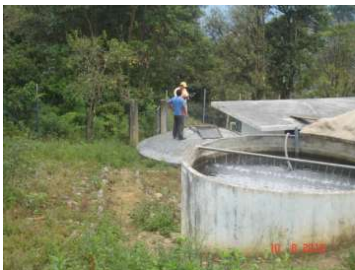
Tanque de reserva vacío por mala operación de manejo
