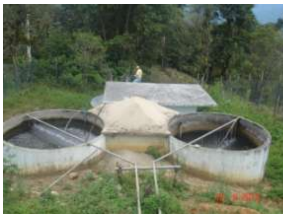
Filtros sin lecho filtrante
