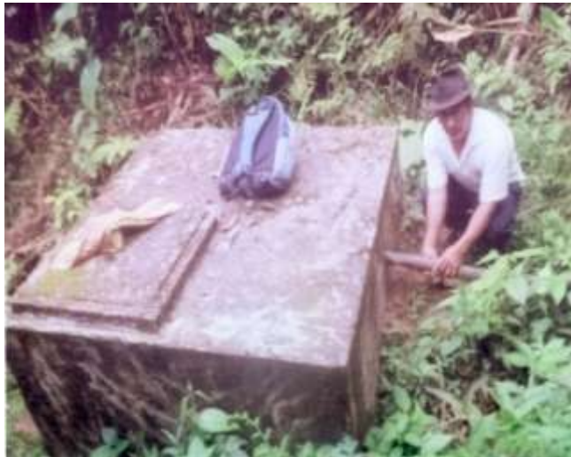
Tanque recolector y distribuidor del sistema de agua de Piuntza Bajo
