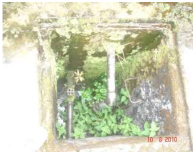
Caja de revisión sin tapa y accesorios y válvulas deteriorados en la planta de tratamiento
