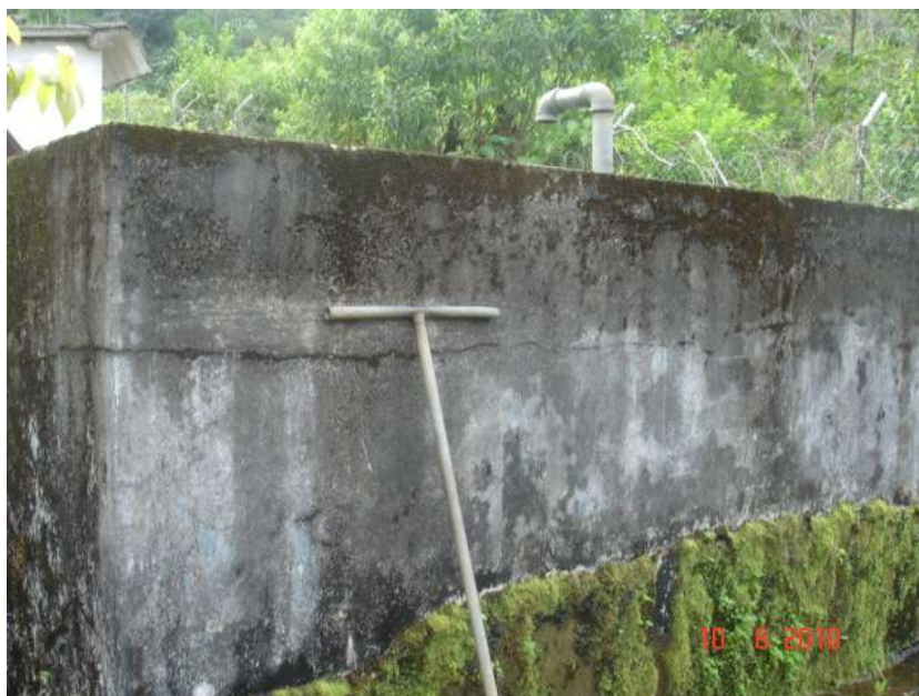
Tanque de reserva fisurado en Planta de Tratamiento La Paz.
