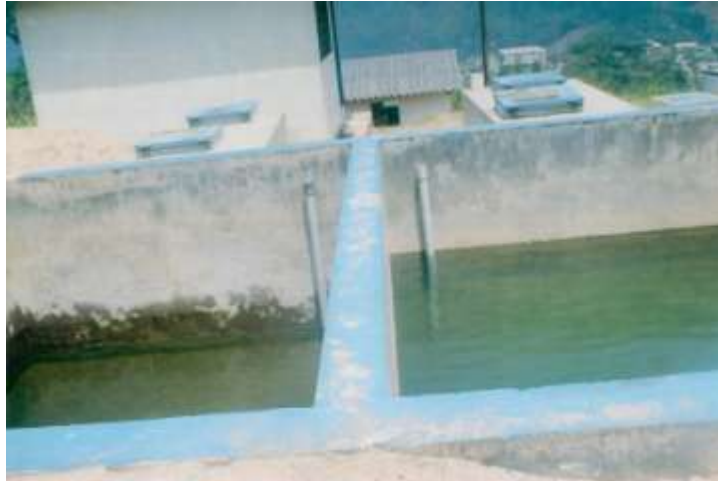
Bandejas de lavado, la bandeja izquierda está en mal estado.
