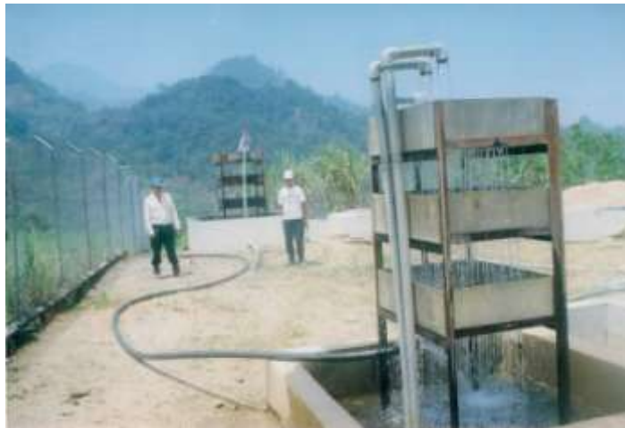
Tolvas de filtración en mal estado; sin material filtrante
