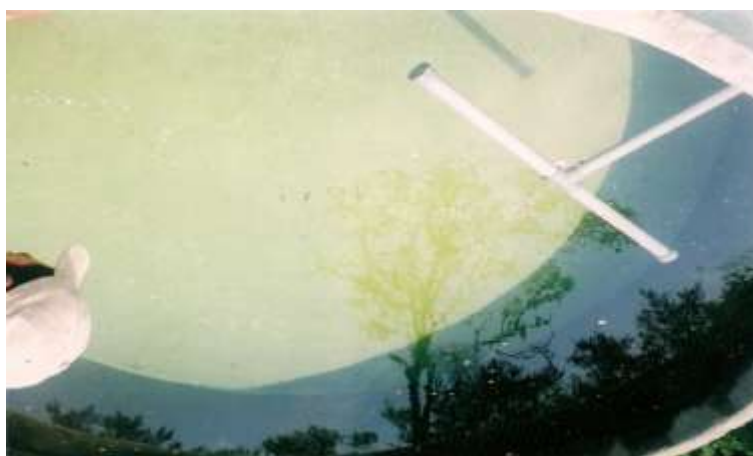
Filtro con lecho filtrante muy fino (sedimentos).
