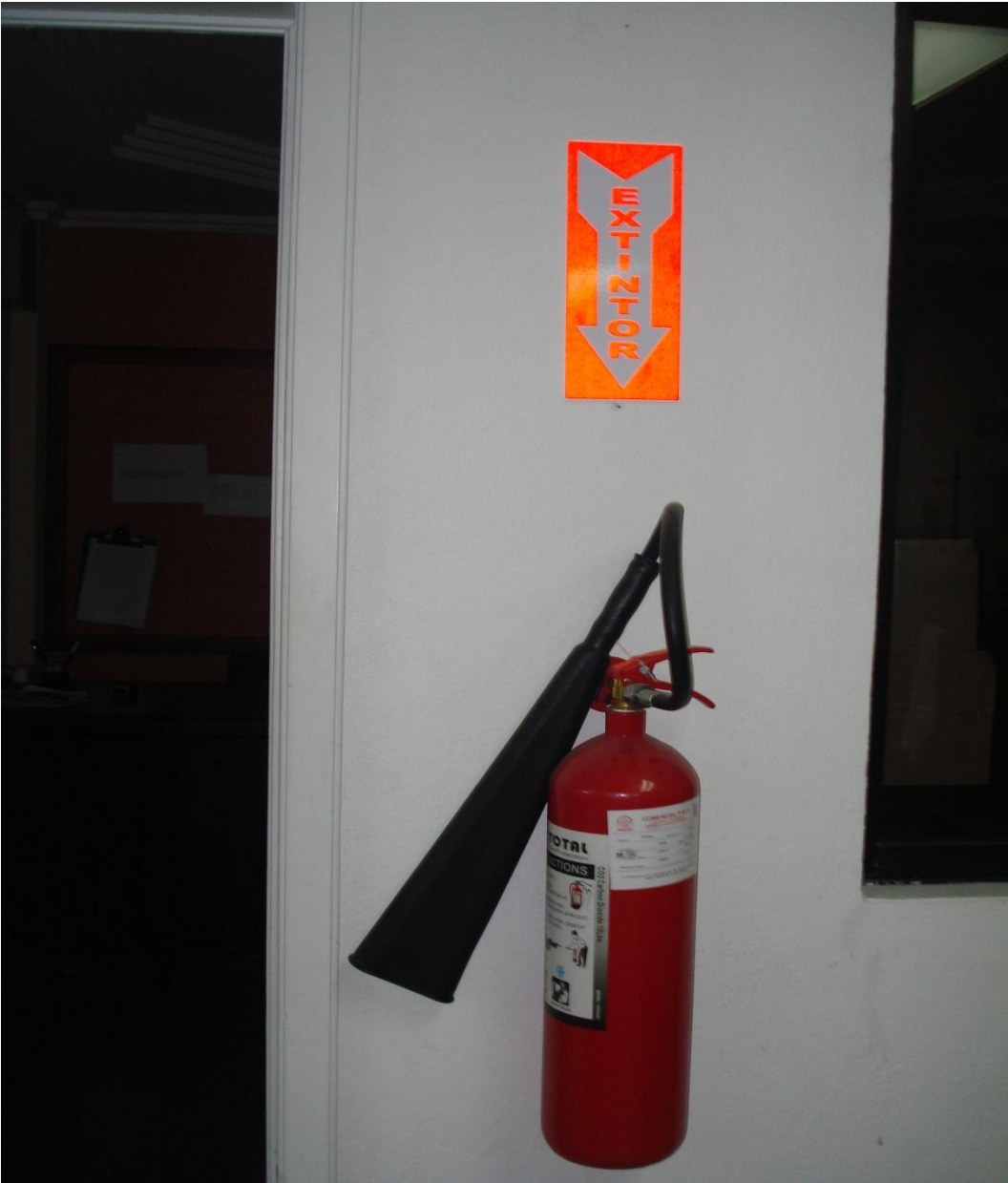
Equipos de seguridad y señalización
