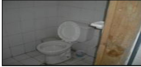
Fotografía N° 6. Área de Instalaciones de Apoyo. Baño perteneciente a la sección de vestidores.
