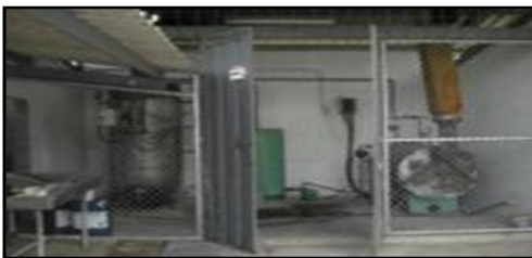
Fotografía N° 9. Área de Máquinas. Vista del Frontal del Cuarto Máquinas.
