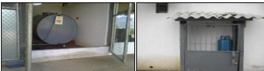
Fotografías N° 10 y N° 11. Área de Almacenamiento de combustibles. Almacenamiento del diesel - Almacenamiento del gas doméstico.
