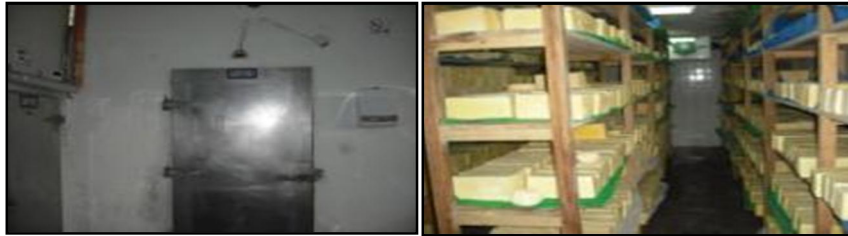
Fotografías N° 3 y N° 4. Vista exterior e interior de los cuartos fríos.
