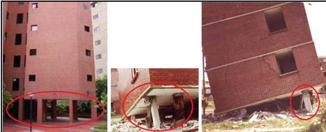
Figura 1.10 Colapso de la estructura debido a piso blando
