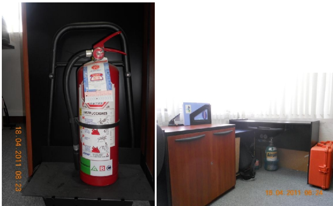
Fotografía 4: Extintor y almacenamiento de gases patrón sin rotular.
