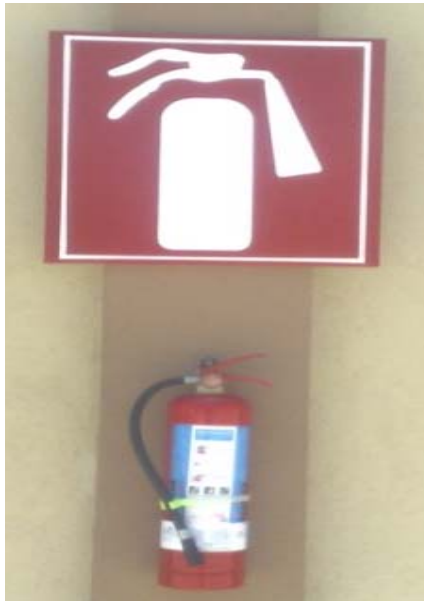
Figura 25 Ubicación del extintor en el parqueadero
