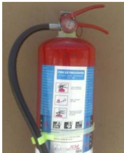
Figura 26 Ubicación del extintor en la sala de espera
