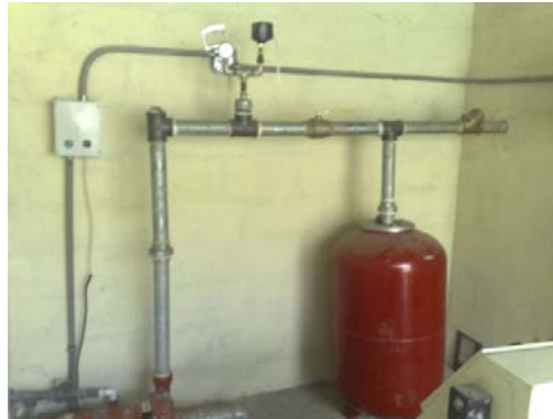
Figura 20 Bomba eléctrica para la cisterna
