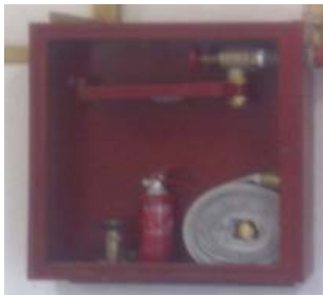
Figura 23 Mangueras contra incendios
