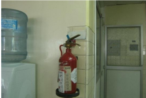
Extintor de incendio (Sin señales)
