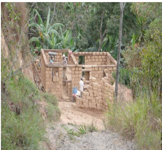
Construcción de una vivienda del cantón Olmedo, utilizando material tradicional como es el “adobe”, la autora, 2010
