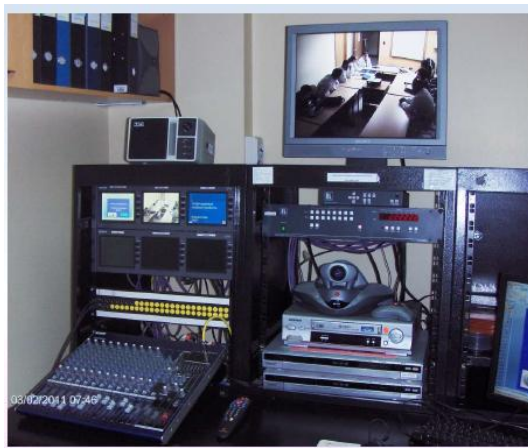
Imagen N° 15: Cuarto de control Hospital de UTPL
