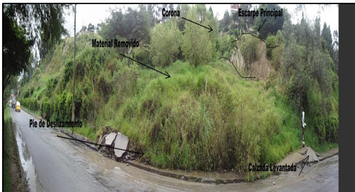
Foto 11.- Deslizamiento 1 junto al parqueadero de estudiantes y a la Av. Santiago de las Montañas.
