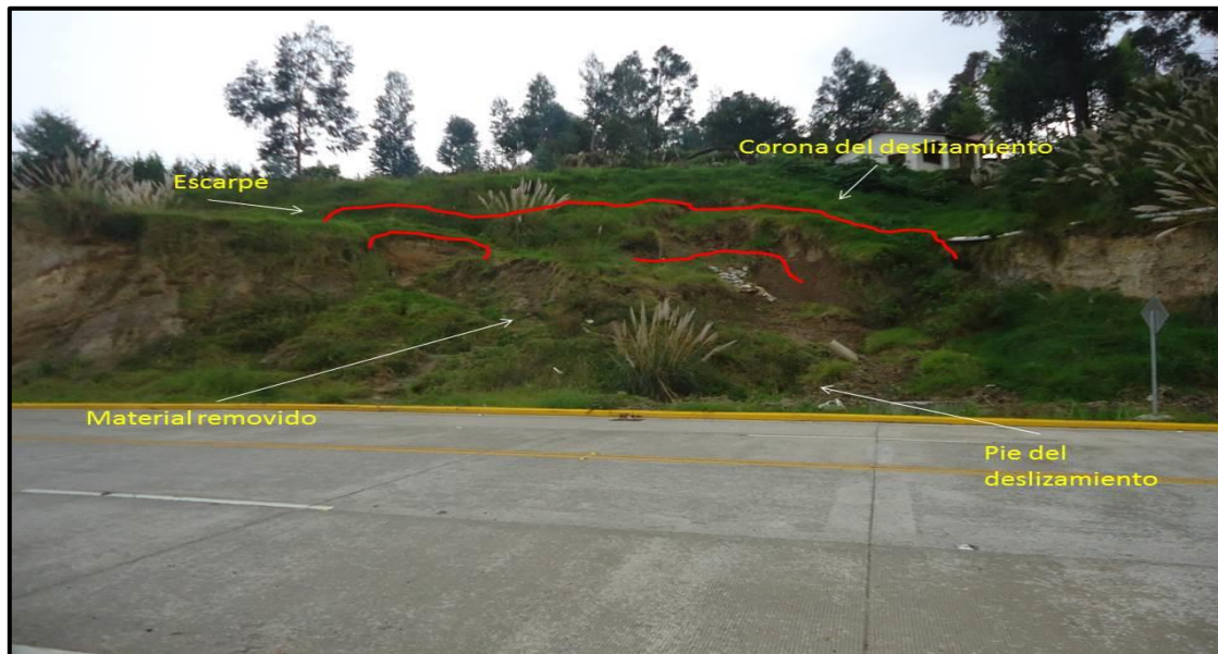
Foto 13.- Deslizamiento 3, junto a la vía Loja – Zamora.
