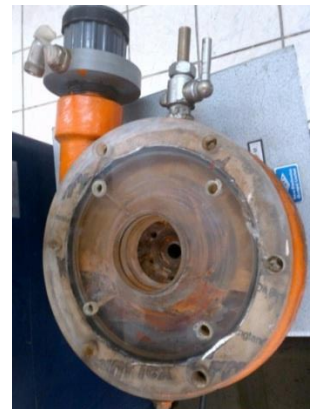
Fig. 16. Estado de la cámara de la bomba centrífuga con óxido en su interior. [Fotografía de autores]
