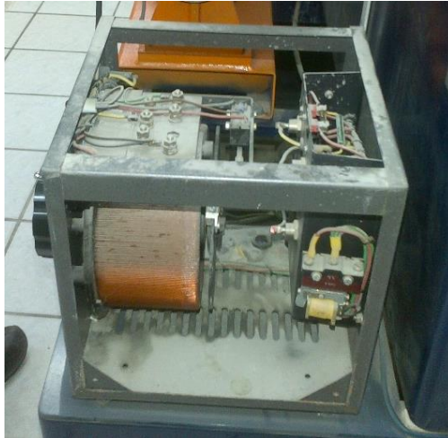
Figura 3.8. Vista interior del variador de frecuencia al momento de la inspección inicial. Fotografía de autores.
