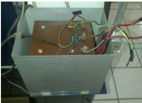
Fig. 19. Vista interior del transformador al momento de la inspección inicial. [Fotografía de autores]
