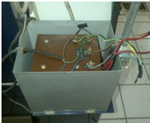
Figura 3.9. Vista interior del transformador al momento de la inspección inicial. Fotografía de autores.
