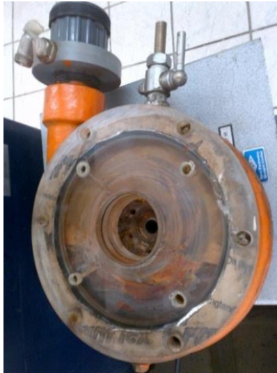
Figura 3.6. Estado de la cámara de la bomba centrífuga con óxido en su interior. Fotografía de autores.
