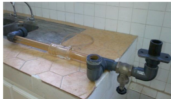
Fig. 21 Tuberías con oxido en las paredes. [Fotografía de autores]
