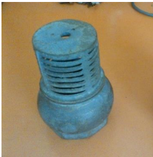
Fig. 13. Estado inicial de la válvula de pie, a la entrada de la bomba. [Fotografía de autores]
