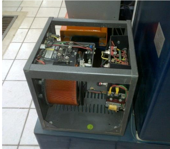
Figura 3.22. Vista lateral del variador de frecuencia original. Fotografía de autores.
