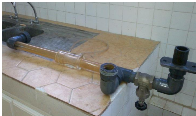
Figura 3.11. Tuberías con óxido en las paredes. Fotografía de autores.
