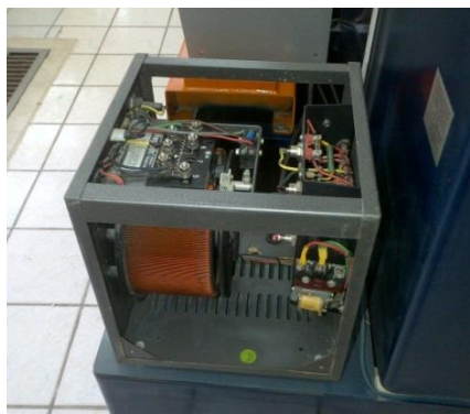
Fig. 32. Vista lateral del variador de frecuencia original. [Fotografía de autores]
