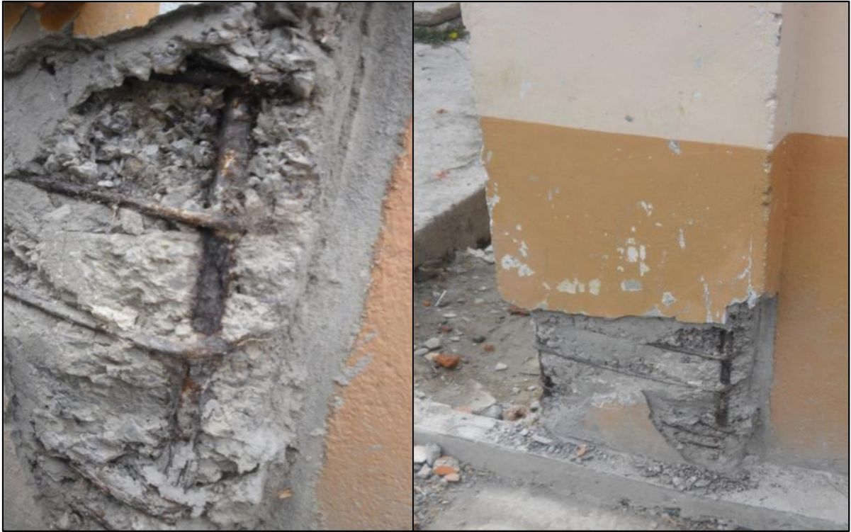
Figura 71. Daño en los elementos estructurales de la Escuela “Alejandrino Velásquez” – Corrosión del acero - Desprendimiento del recubrimiento Fuente: El autor
