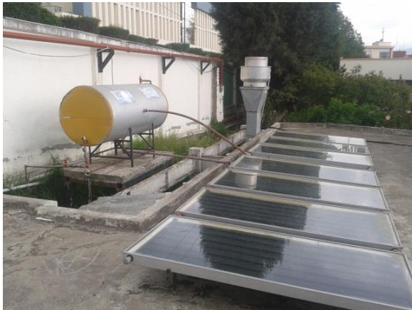
Fig. 2. Bloque termosolar del sistema de provisión de ACS a la CU UTPL. Fotografía de los autores.
