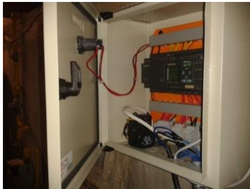
Figura 4. Tablero de control del sistema de provisión de ACS a la CU. Fuente: Fotografía de los autores.
