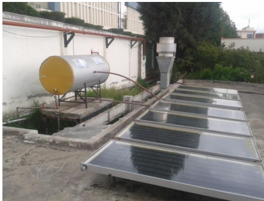
Figura 2. Bloque termosolar del sistema de provisión de ACS a la CU.
