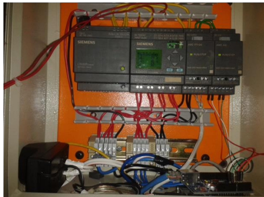
Figura 16. Instalación de los bloques de adquisición y registro, y, comunicación.
