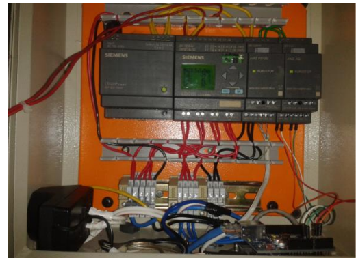
Fig. 15. Instalación de los bloques de adquisición y registro, y, comunicación. Fotografía de los autores
