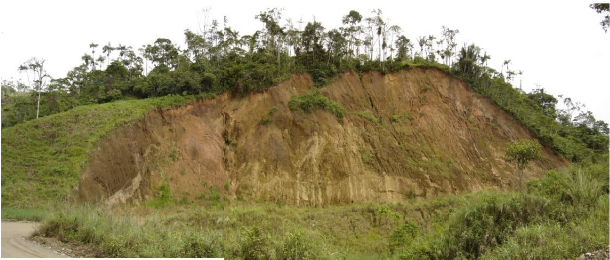
Figura 12: Deslizamiento rotacional (Talud 3) Fuente: El autor
