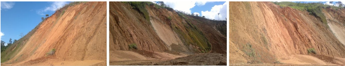
Figura 10: Presencia de Flujos de lodo (Talud 1) Fuente: El autor
