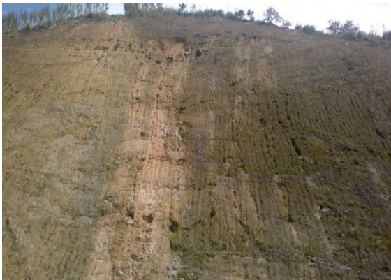
Figura 9: Proceso erosivo en la cara expuesta del talud. Fuente: El autor
