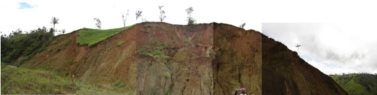
Figura 11: Deslizamiento rotacional y flujos (Talud 2) Fuente: El autor.
