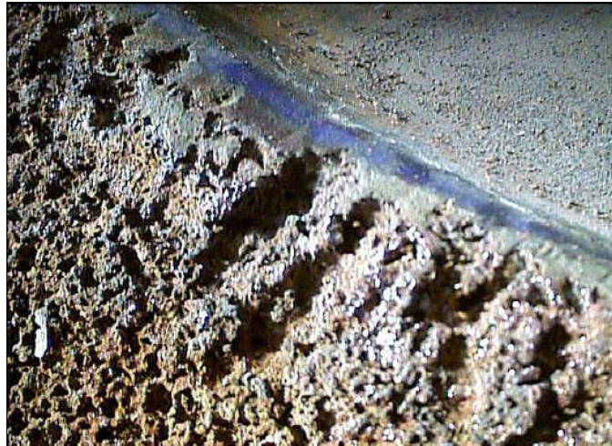
Figura 2.12 Erosión por cavitación en una válvula de mariposa Fuente: La cavitación en sistemas de tuberías, Uralita sistemas de tuberías.
