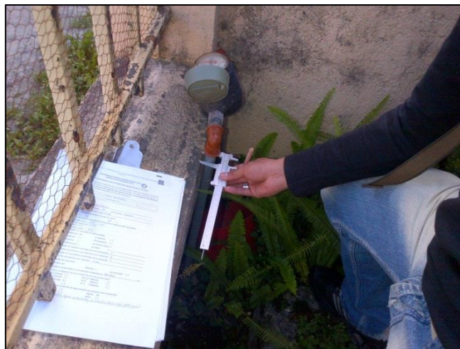
Figura 4.21. Medición del diámetro de la tubería conexión domiciliaria Fuente: archivo personal
