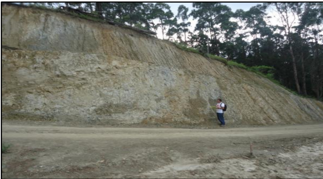
Foto3.- Arcillas con alteraciones.
