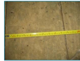
Tablón del piso de escuela antigua Fuente: Autora Fuente: Autora Año: 2008
