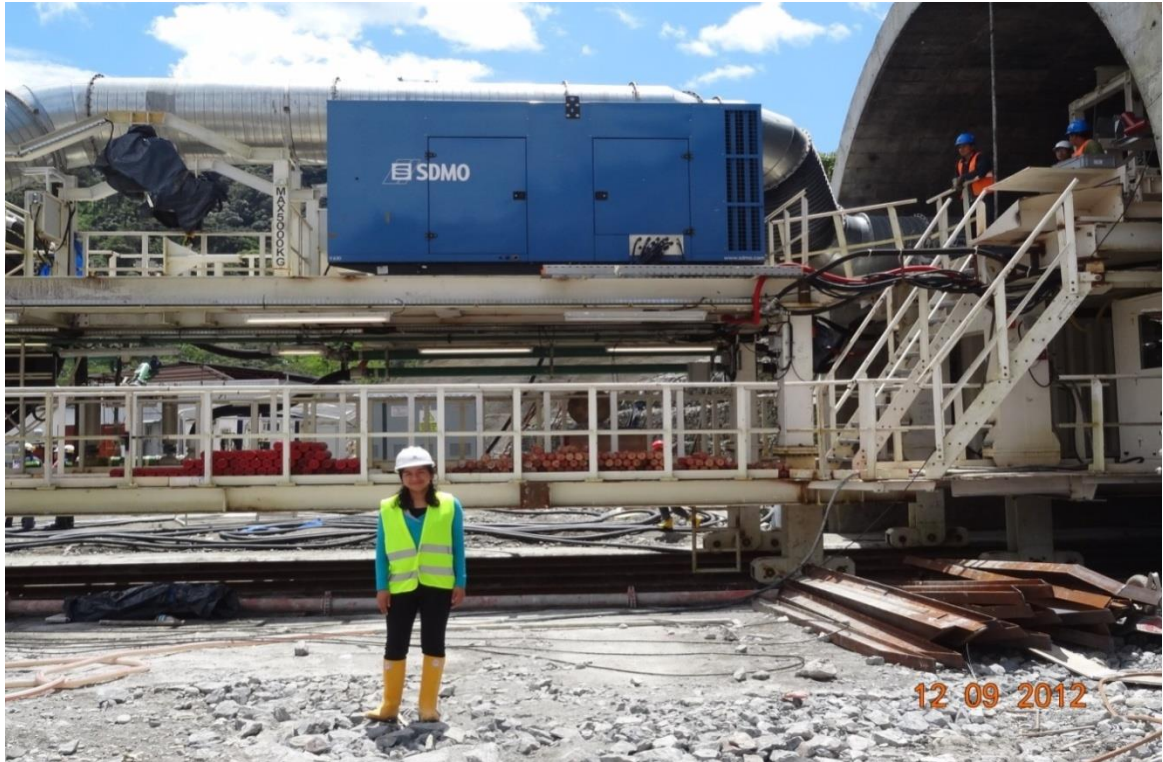
ANEXO 5. Casa de Maquinas del Proyecto Coca Codo Sinclair
