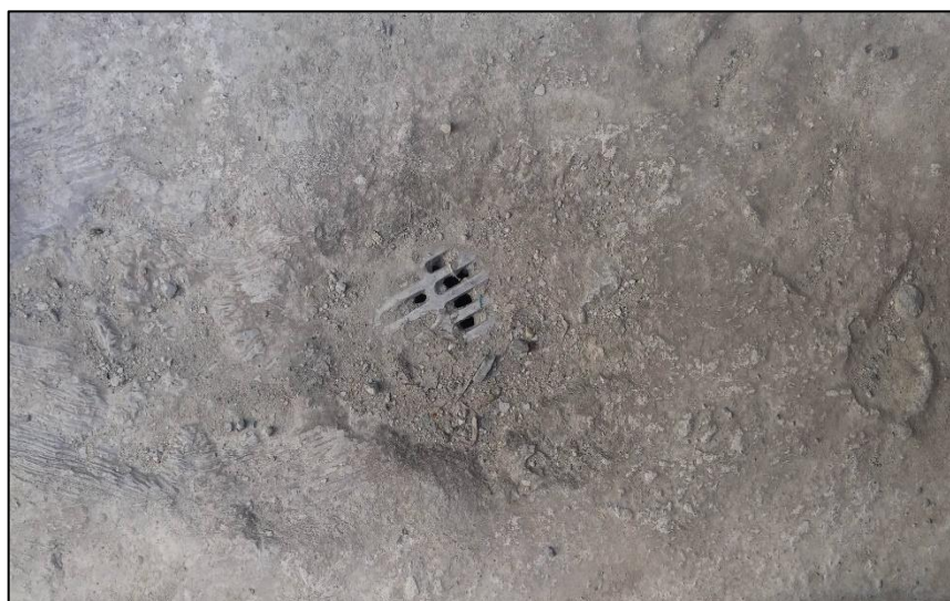
Figura 10. Desgaste de la superficie de hormigón por el rápido movimiento del agua.
