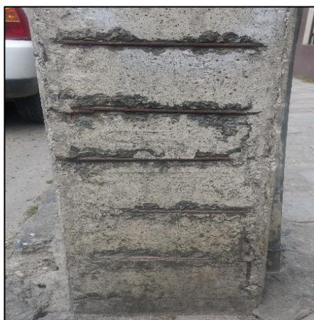
Figura 3. Corrosión del acero de refuerzo por carbonatación.
