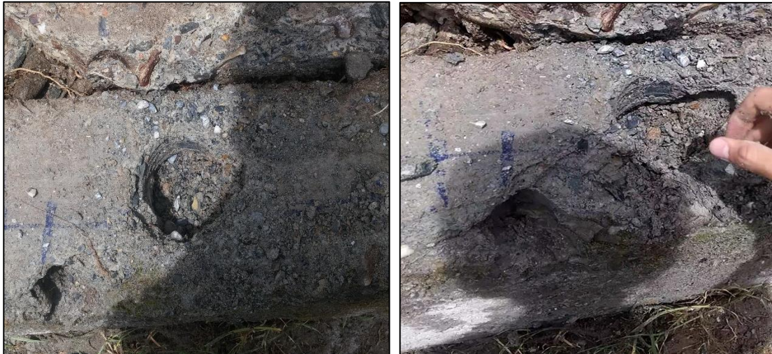
Figura 39. Desprendimiento de una parte de la cadena de hormigón con la mano.
