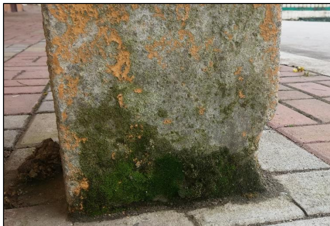
Figura 12. Desintegración de una columna de concreto.
