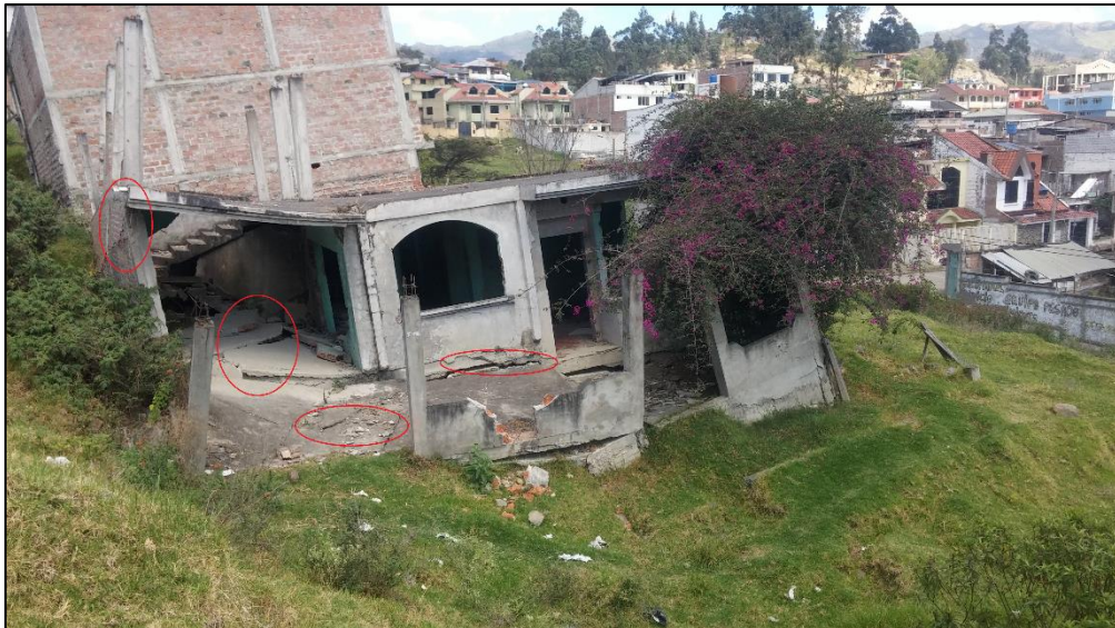
Figura 9. Aparición de fisuras por asentamientos diferenciales.
