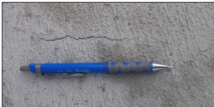
Figura 7. Fisura por contracción plástica.
