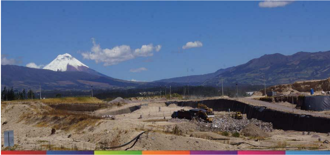
Ilustración 8 Relleno sanitario del Distrito Metropolitano de Quito, El Inga Fuente: Empresa Pública Metropolitana de Gestión Integral de Residuos Sólidos (2017) Elaborado por: Empresa Pública Metropolitana de Gestión Integral de Residuos Sólidos
