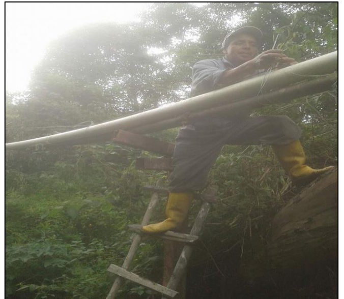
Paso de la tubería por la quebrada
