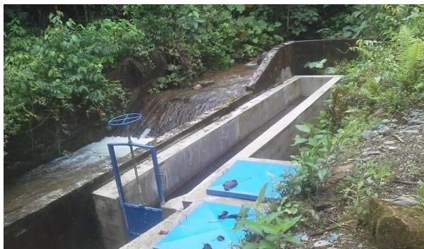
Zona de captación Barrio San Roque
