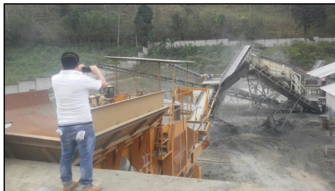
Figura 19. Triturador primario de mandíbula Fuente: Planta de trituración del G.P.A.O. (Panupali) Elaborado por: El autor
