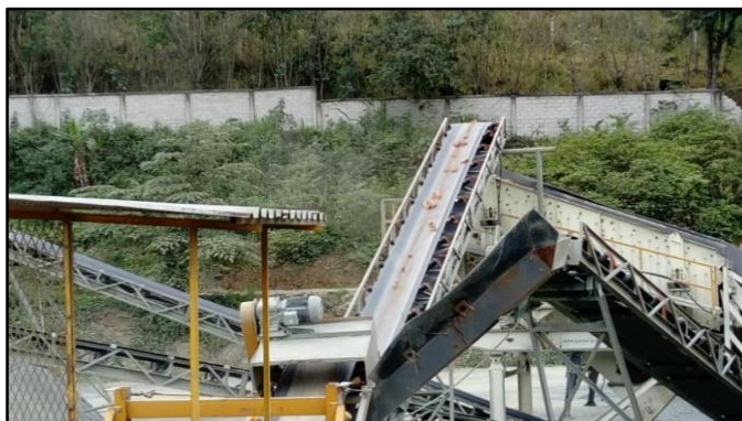
Figura 25. Ciclos de trituración de clasificación 2 Fuente: Planta de trituración del G.P.A.O. (Panupali) Elaborado por: El autor
