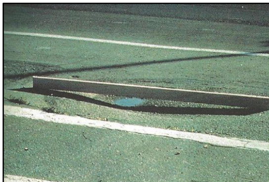
Figura 12. Calzada asentada por un relleno incorrecto Fuente: (Instituto Español del Cemento y sus Aplicaciones, 2013) Elaborado por: (Instituto Español del Cemento y sus Aplicaciones, 2013)
