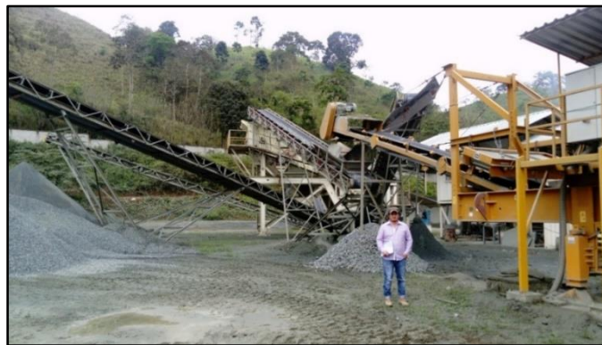
Figura 18. Planta de trituración del G.P.A.O. (Panupali) Fuente: Planta de trituración del G.P.A.O. (Panupali) Elaborado por: El autor
