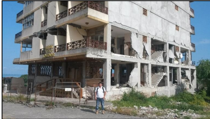
Figura 14. Estructura afectada producto del terremoto
